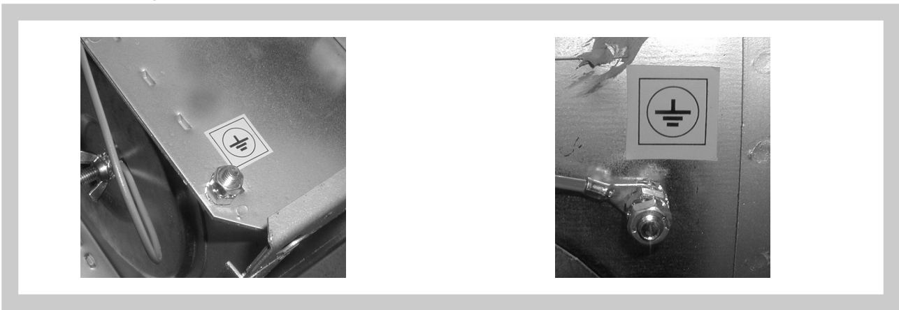
Abb. 4 Erdungsschraube der Brandschutzklappe
